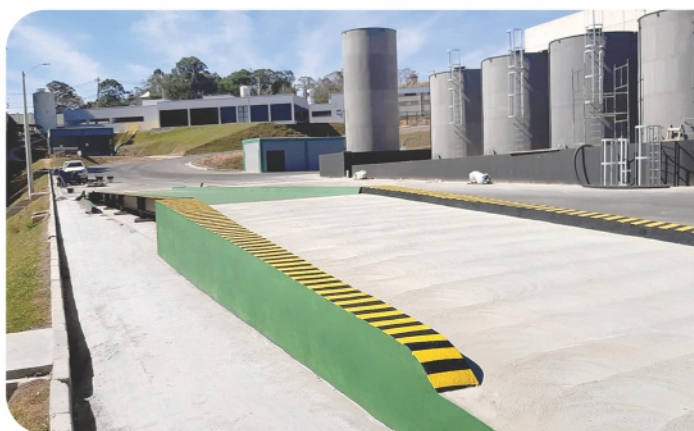
Balança sobre o piso
