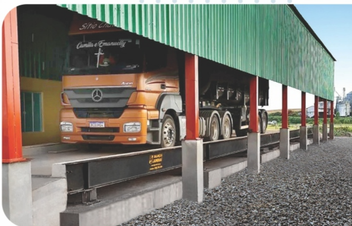
Balança sobre o piso
