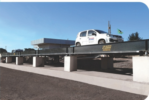
Balança sobre o piso
